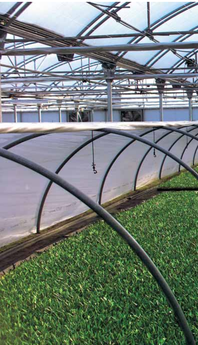
Detalle de las instalaciones en Molina.
